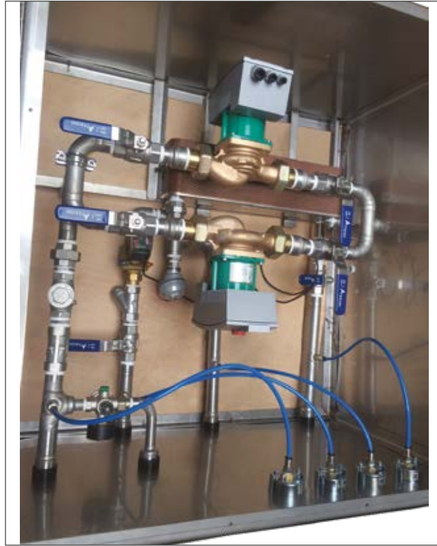
Chiller ile üniteler arasında devre ayırma cihazıdır.
